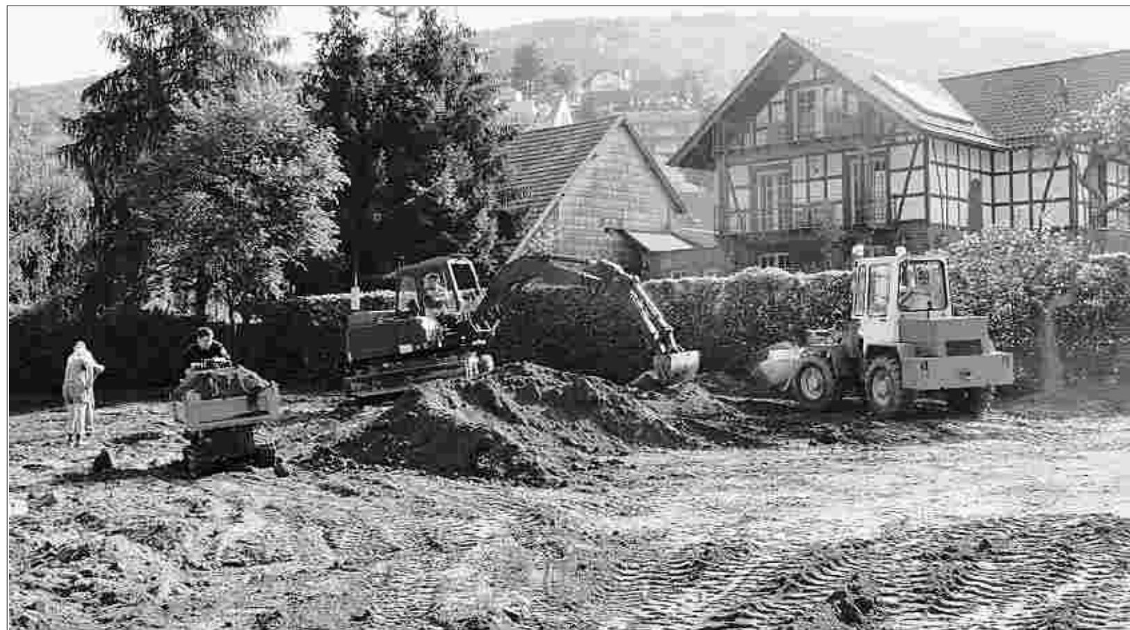
Bald soll das neue Naturerlebnisschwimmbad in Einruhr fertig sein. Am Wochenende wurde mit zwei Schaufelbaggern fast 400 Tonnen Mutterboden verteilt. Foto: Sarah Schmidt
