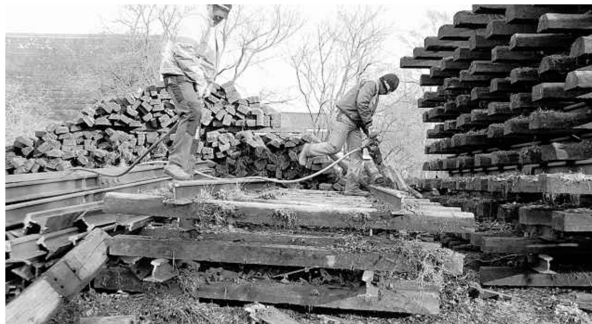
Der Bahnhof in Roetgen, an dem vor 100 Jahren täglich 50 Züge aus- und einfuhren, ist zum Sammel- und Arbeitsplatz geworden: Die abgebauten Gleise werden dort angeliefert, dann werden die Schienen von den Schwellen getrennt und für den weiteren Transport aufgestapelt.
