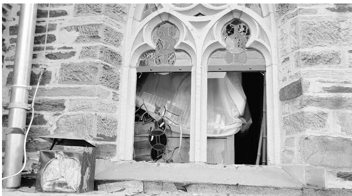
Vandalismus in Lammersdorf: Nicht nur an der Leichenhalle, auch am Kirchengebäude gab es massive Zerstörungen.
